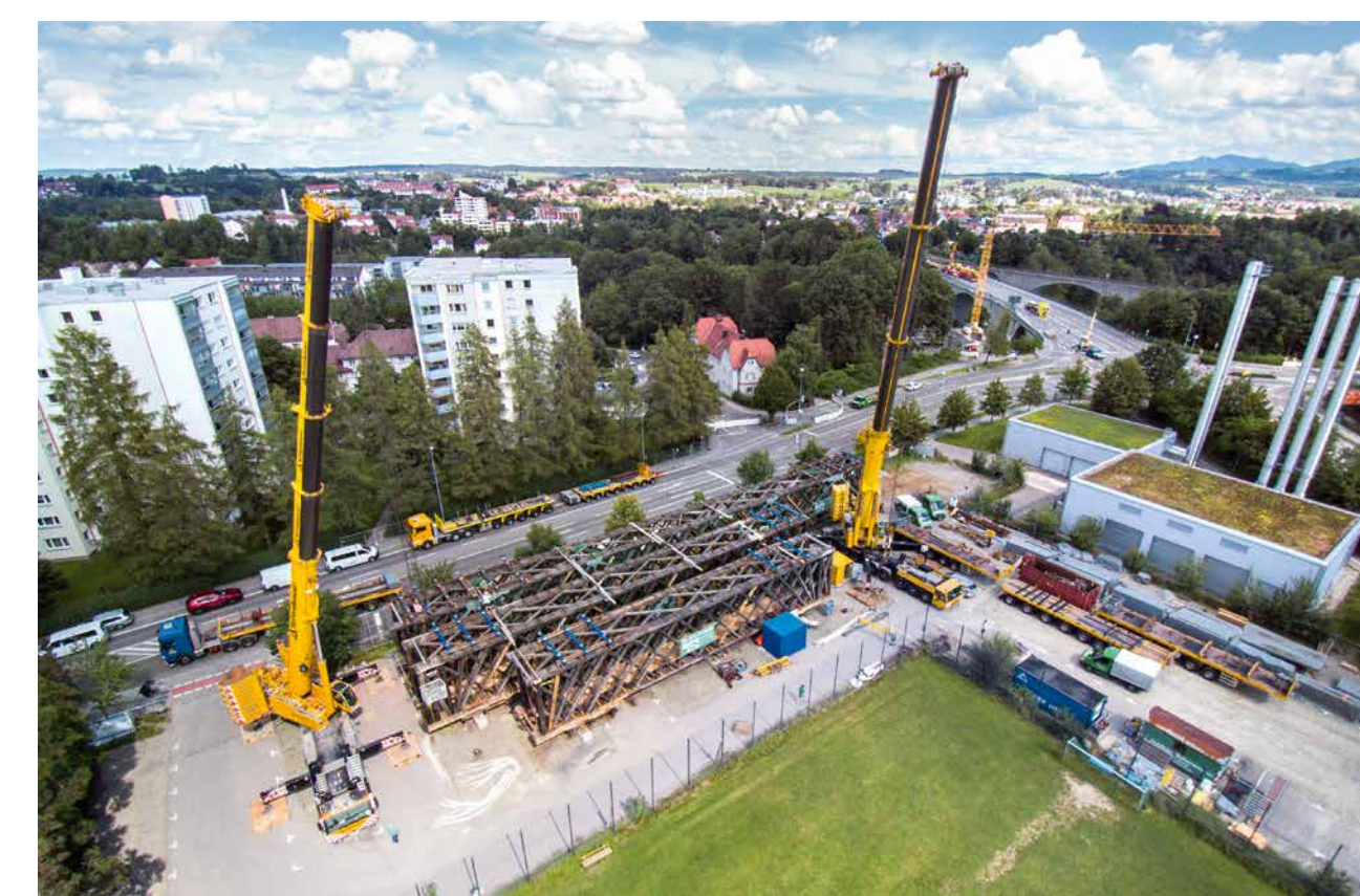
Arbeiten auf der Feldwerkstatt in unmittelbarer Nähe zum Brückenstandort (Foto: Silberstein, Hermann Rupp)
